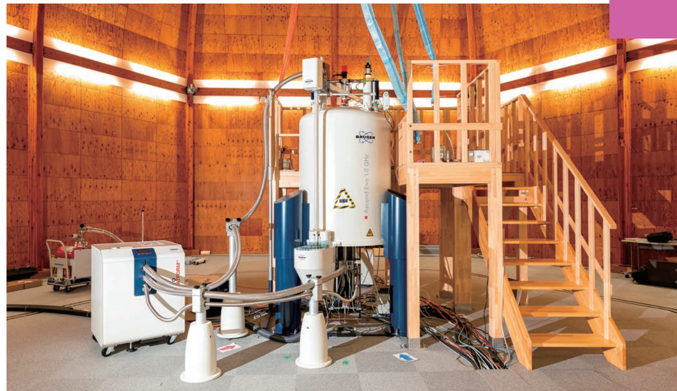
▲ 核磁気共鳴現象を利用して分子の構造を調べるNMR装置。液体ヘリウムで-269°C(4K)に冷却した超電導マグネットにより、円筒の中心部には23.5テスラ(プロトン共鳴周波数1.0GHzに相当)という強い静磁場がかけられている。装置周囲の構造物や建物には、この磁場を乱さないように木材などの非磁性体を使用。
